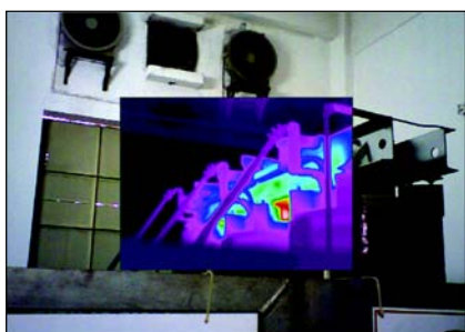
供电系统检测
