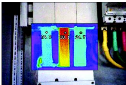
供电母排工作是否正常
