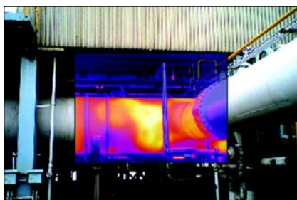
管道内衬磨损
